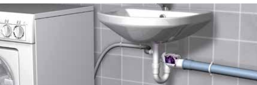
Lavatórios com sifões e ligação para máquina de lavar
